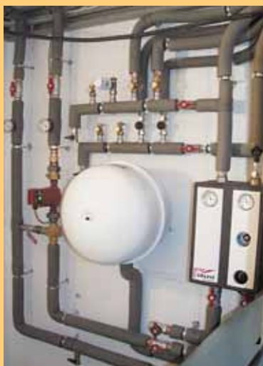
Im Technikraum: Hier laufen die sauber verlegten Anschlüsse der beiden Wärmequellen zusammen.
