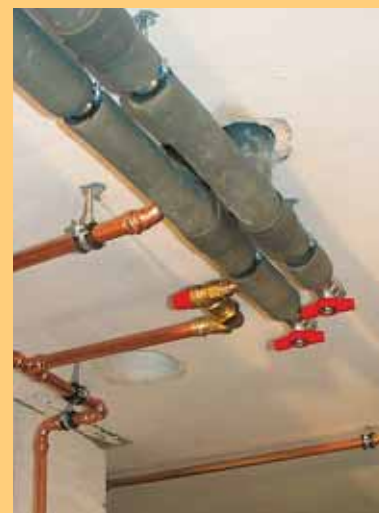
Ausbaufähig: An die Leitungen mit den roten Ventilen kann später ein Pellets-Heizofen angeschlossen werden.
